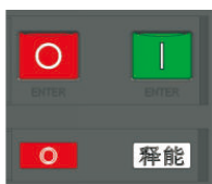
断路器断开且无储能状态
