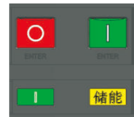
断路器合闸且已储能完毕状态
