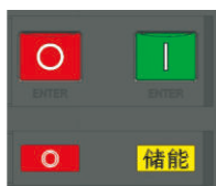
断路器断开且已储能完毕状态
