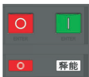
断路器断开且无储能状态
