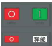
断路器断开且无储能状态
