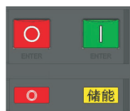
断路器断开且已储能完毕状态
